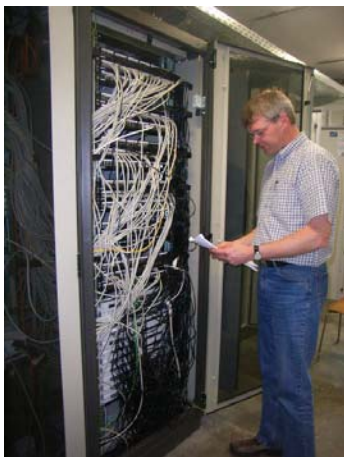
Ein Auszubildender überprüft die Netzwerk-Verkabelung in einem Verteilerschrank
